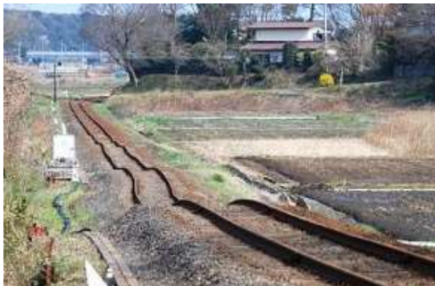
↑ Wikiwand 東日本大震災による鉄道への影響
